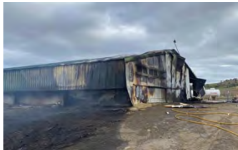
Estado en el que ha quedado la granja tras el incendio
